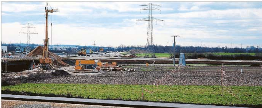
Auf den momentan brach liegenden Flächen neben der Baustelle flattern Absperrbänder. Diese sollen Wiesenbrüter davon abhalten, auf den Wiesen und Ackerflächen, die noch bebaut werden, zu brüten. (Fotos: Löw).
